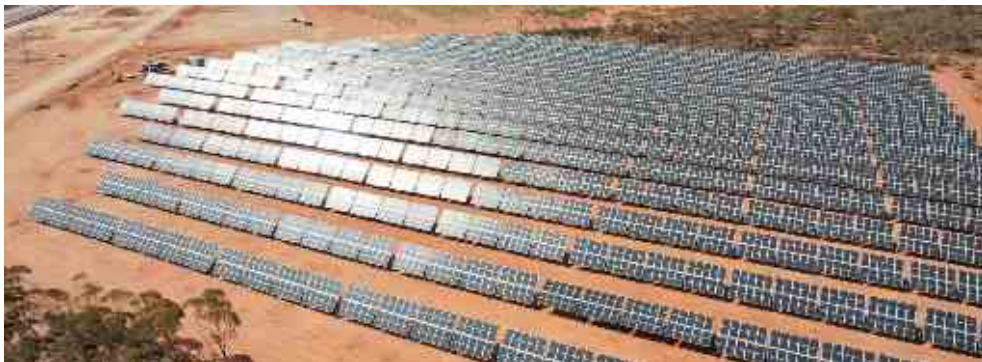
诺顿金田的光伏发电阵列
